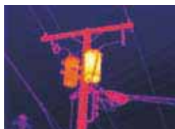
Перегретый полюс трансформатора
