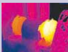
Перегрев крышки подшипника
