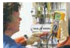
Проверка изоляции в распределительном щите
